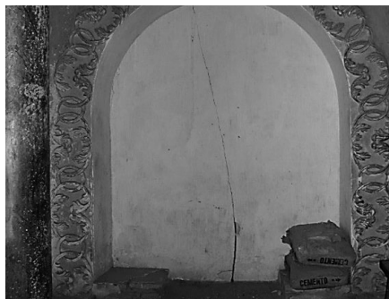
Grieta por asiento. Iglesia de Sotomayor – Chuquisaca, Bolivia
