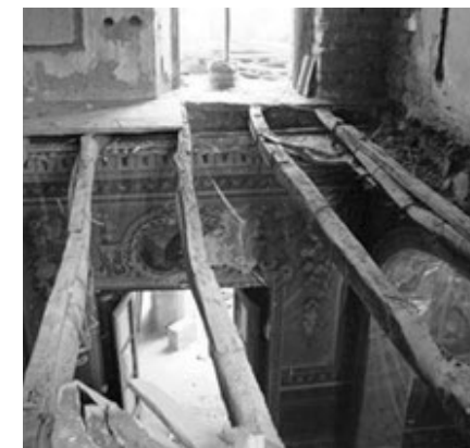
Alabeo de vigas. Palacete de la Florida – Chuquisaca, Bolivia
