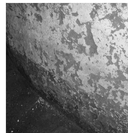
Desprendimiento de pintura a la cal. Pasillo convento de Santa Clara – Sucre – Chuquisaca, Bolivia
